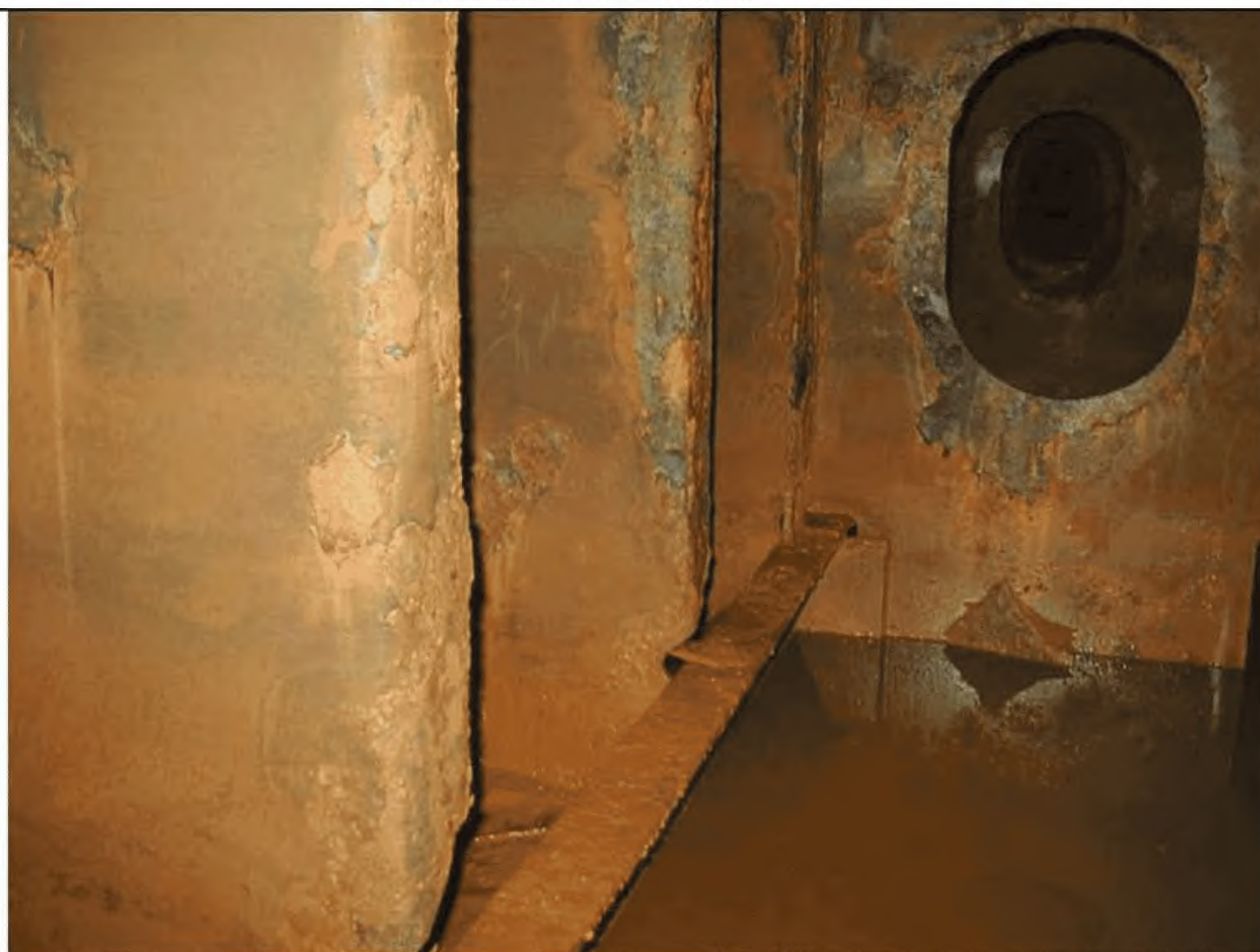
ПЛОХОЕ СОСТОЯНИЕ ПОКРЫТИЯ
