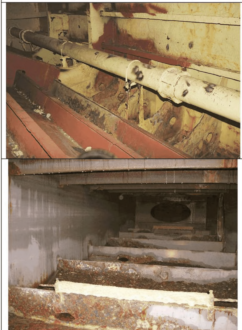
ПЛОХОЕ СОСТОЯНИЕ ПОКРЫТИЯ
