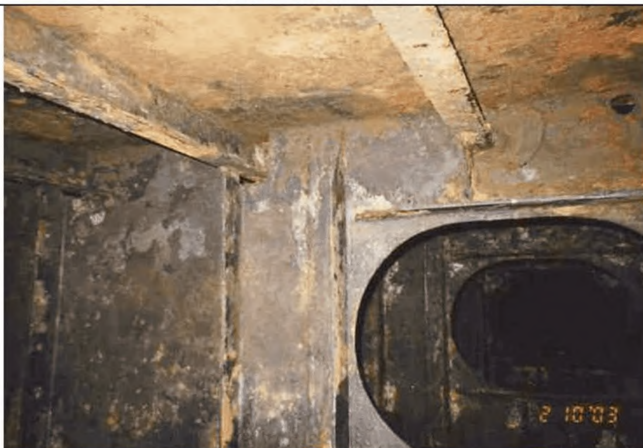
ПЛОХОЕ СОСТОЯНИЕ ПОКРЫТИЯ
